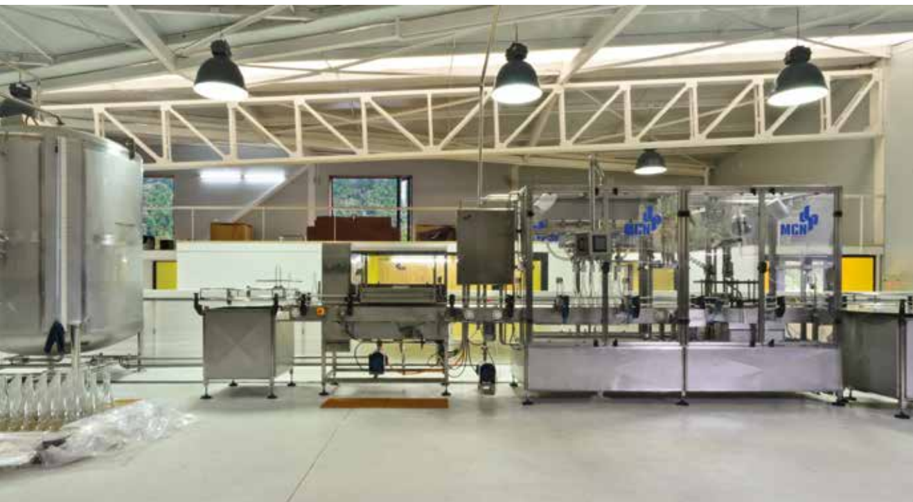
Gli impianti per l'imbottigliamento e l'atrio
