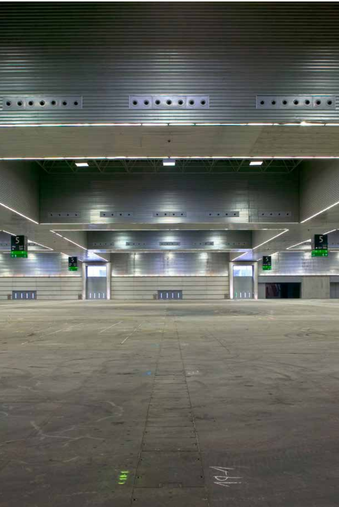
Bilbao Exhibition Center. El gran volumen y el factor del uso diverso y complejo condicionan el diseño de instalaciones MEP, que el diseño se resuelve aportando flexibilidad y fiabilidad a los sistemas.
