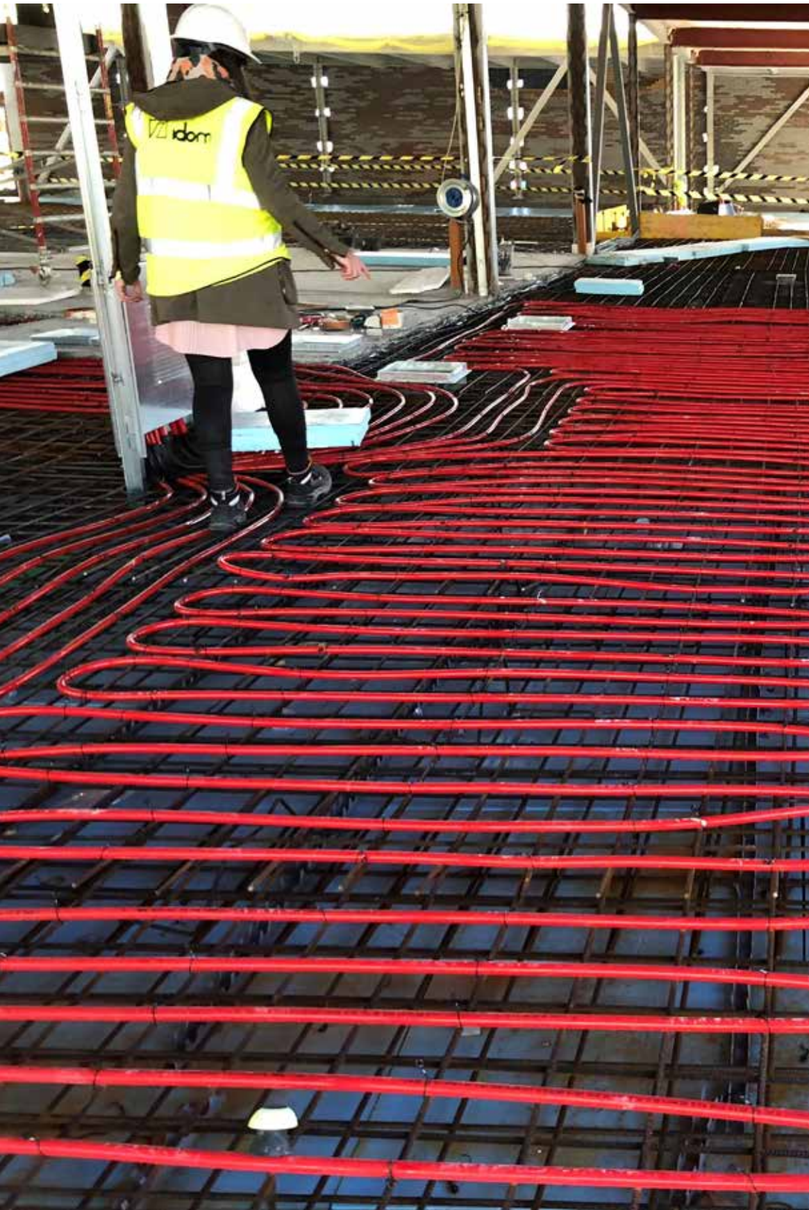
Termoactivación energética en el edificio del Nuevo Campus de Red Eléctrica en Tres Cantos (Madrid)
